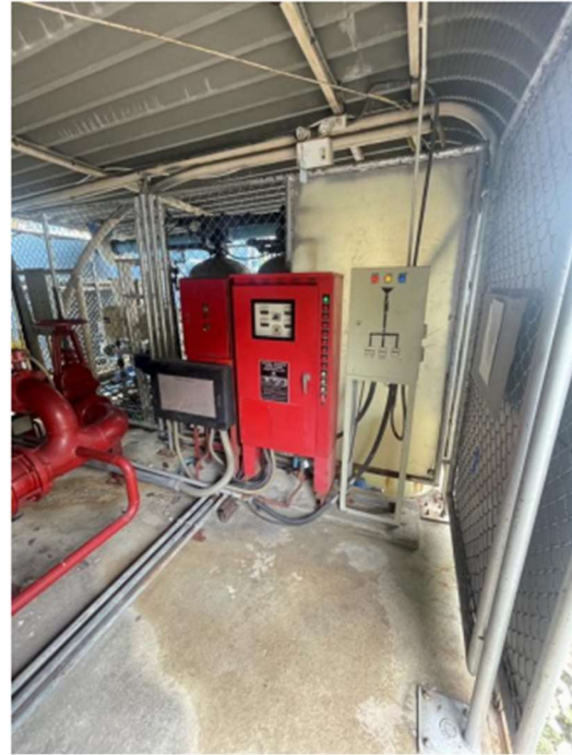
ภายในโรงที่ตั้งปั้มน้ำดับเพลิง
