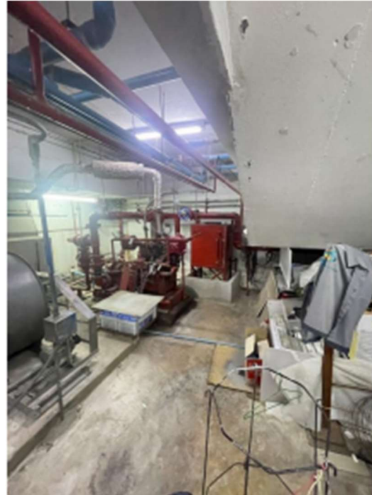
ปั๊มน้ำ และปั๊มดับเพลิง ชั้นใต้ดิน
