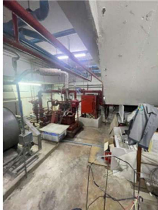
ปั้มน้ำ และปั้มนดับเพลิง ชั้นใต้ดิน
